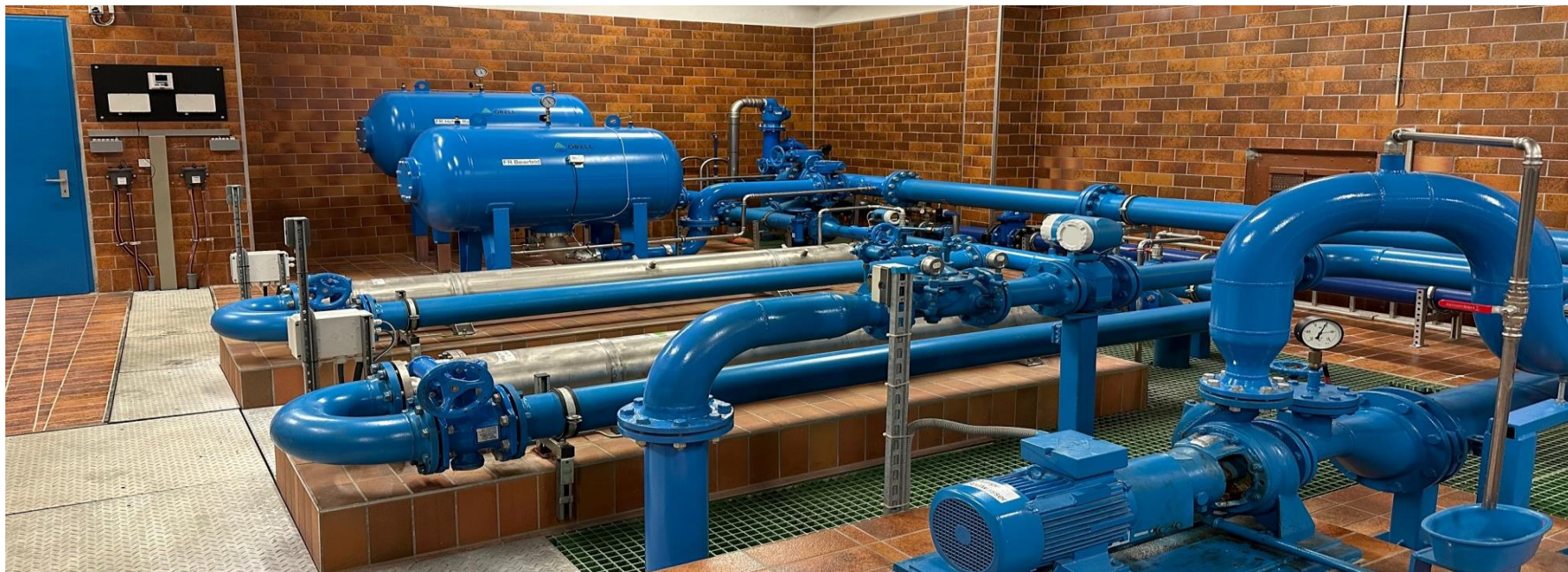
Pumpstation Westerkgebirge, Deutschland
