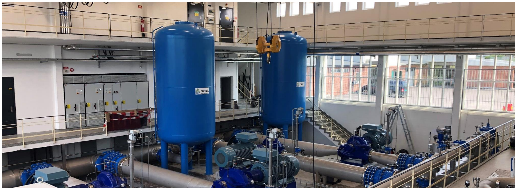
Pumpwerk Seierstad, Norwegen
