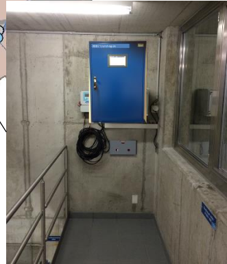
Stromversorgte Quell-Messstelle Goldingen
