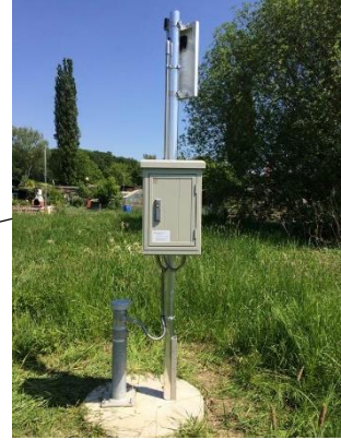
Autonome Piezometer-Messstelle Schaffhausen
