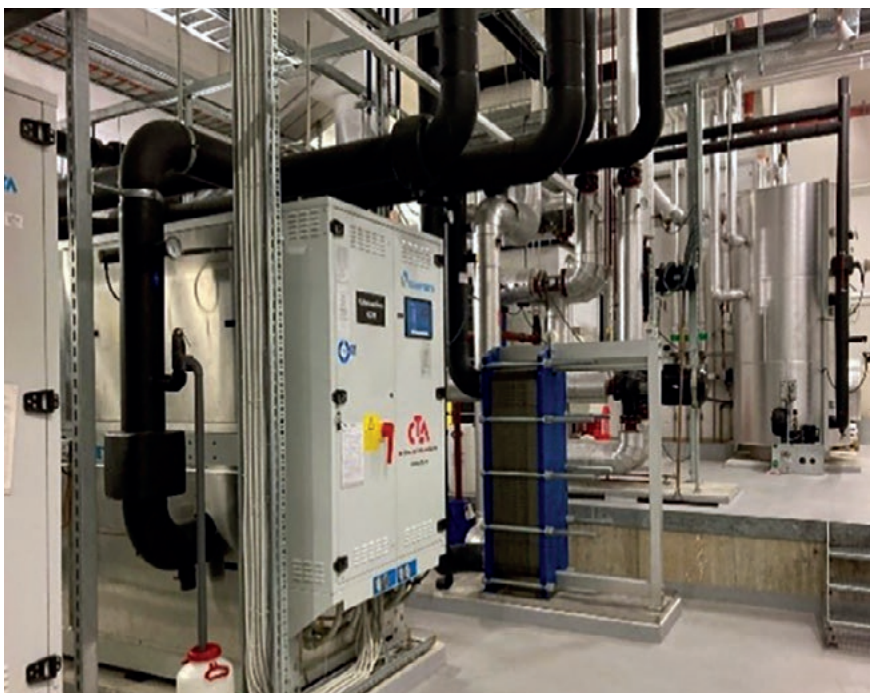
Einblick in die Technikanlagen des Wankdorf-YB-Stadion
