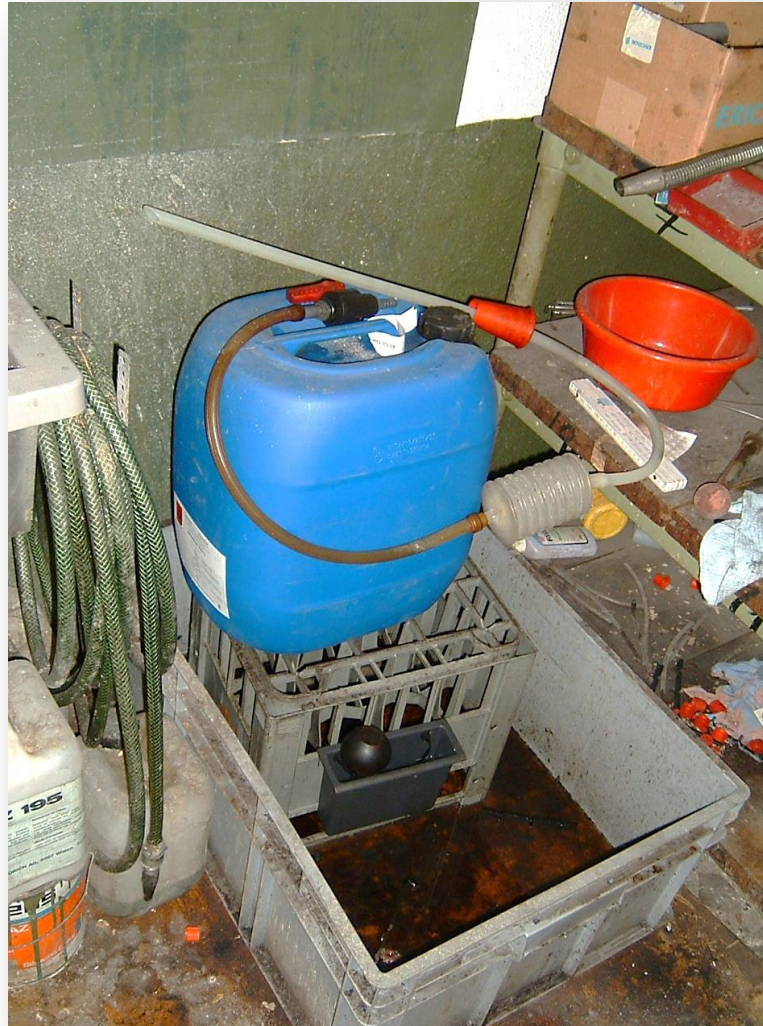
Säurestation in Autogarage
