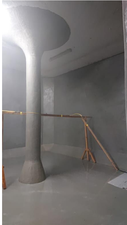
Abb. 2: Nach Sanierung mit natürlich-mineralischer Beschichtung
