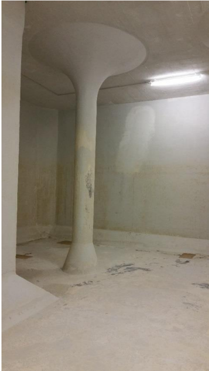
Abb. 1: Schadenbild der Wasserkammer vor Sanierung
