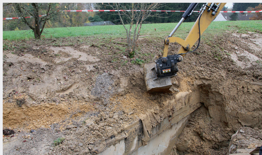
Fig. 9 Auf der Reservoirdecke ist die Bitumenbeschichtung z. T. beschädigt. Die Reservoirwand liegt ungeschützt im Erdreich
