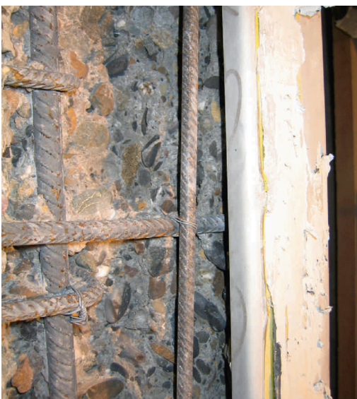
Fig. 6 Bewehrung in der Nähe des rostfreien Rahmens einer Drucktüre Armature à proximité du cadre inoxydable d'une porte à pression (Quelle: IWB)
