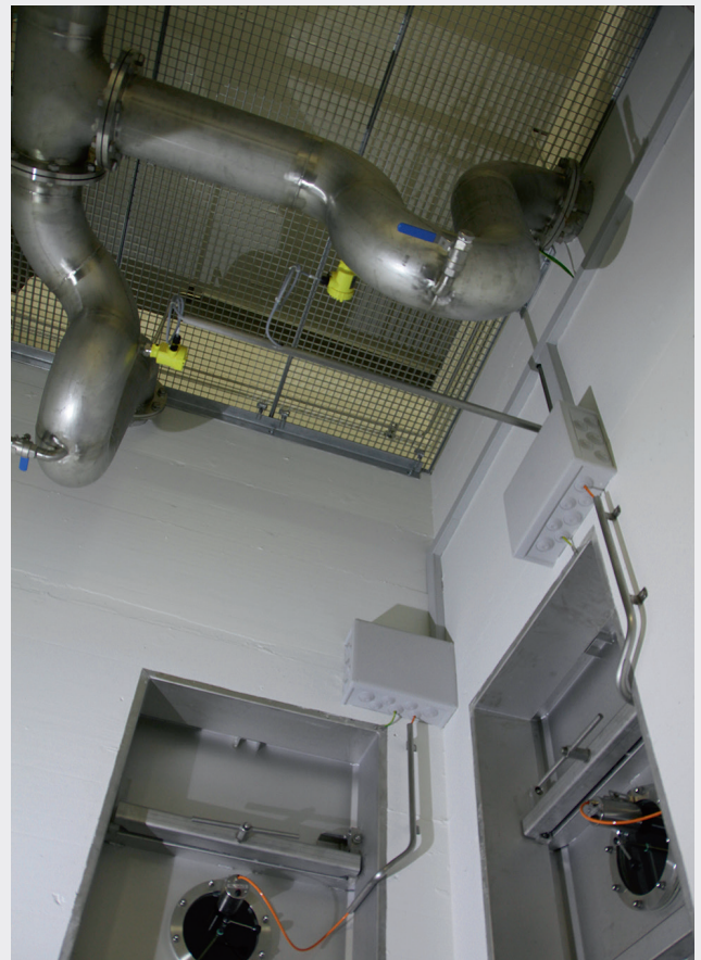
Fig. 7 Reservoirüberlauf aus beiden Kammern. Der Wasserstand im Siphon wird mit einer Schwinggabelsonde überwacht (gelbes Messgerät)
