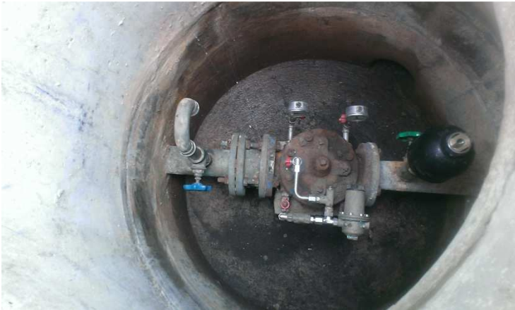
Verschmutzung eines DRV Schachtes
