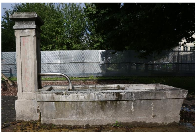
Abb. 3 Brunnen, bei dem der Konsum ab der Röhre verunmöglicht wurde, indem die Röhre bis knapp über die Wasseroberfläche verlängert wurde. Der Brunnen befindet sich bei einem Kinderspielplatz.
