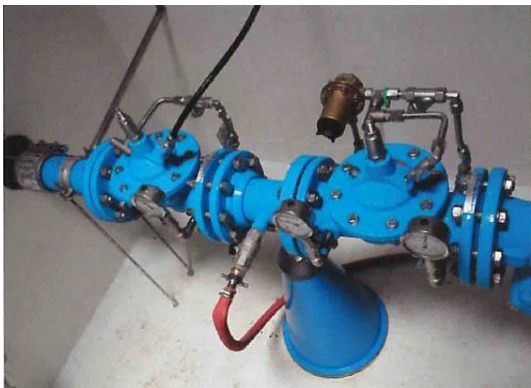
Druckreduzierventile im Armaturenschacht
