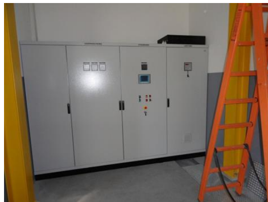
Schaltanlage KW Seedorf
