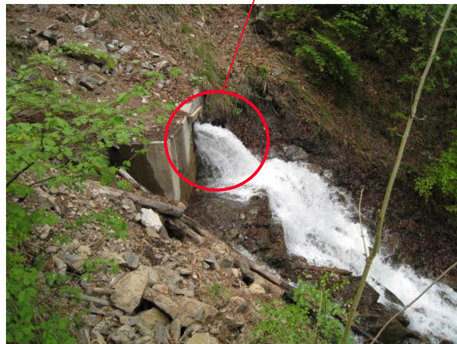
Trop-plein captage Chuchibach
