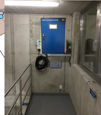
Station de mesure alimentée en électricité - source Goldingen
