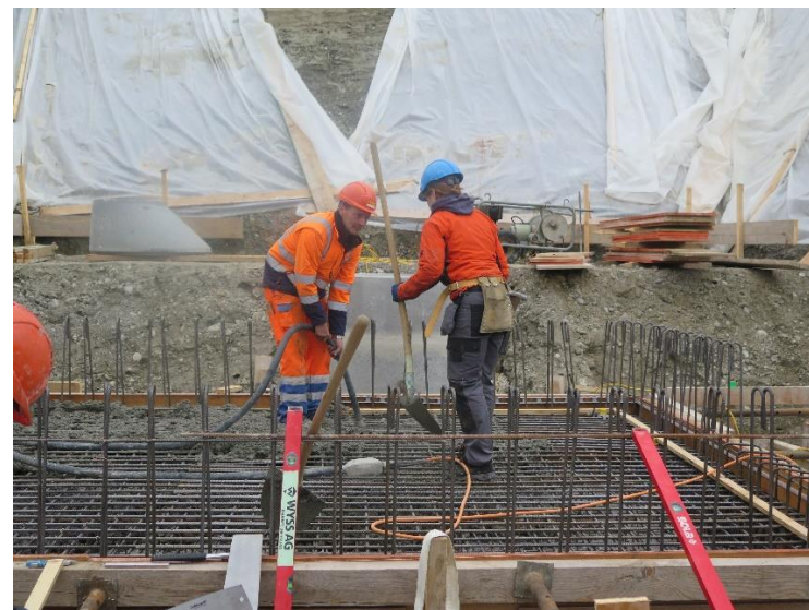
Armement et mise en place du béton selon les règles de l'art
