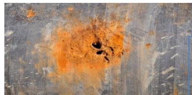
Corrosion par piqûres
