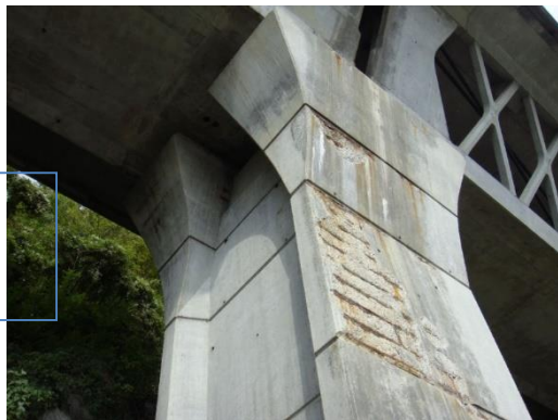
Abplatzungen des Betons
