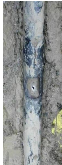
Loch in der Leitung
